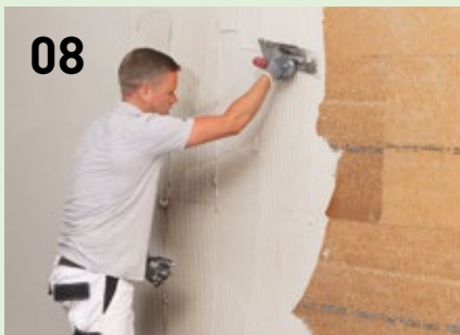
08 Die an der Wand angebrachten Dämmplatten mittels Zahnkelle und PP Fill vollflächig verspachteln.
