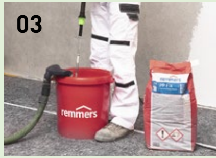
03 PP Fix, ein Klebemörtel für die Schimmelsanierung, mit dem Festool Rührwerk MX 1200 und dem Rührkorb HS3L anmischen.
