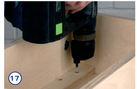
17. Danach wird die Leiste einfach mit zwei Spaxschrauben von innen unter die Deckelplatte geschraubt. Bitte keinen Leim angeben, dann können Sie später die Leiste falls nötig auch mal auswechseln.
